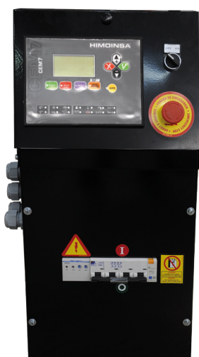
Cuadro de Grupo con Protección Magnetotérmica y Diferencial
